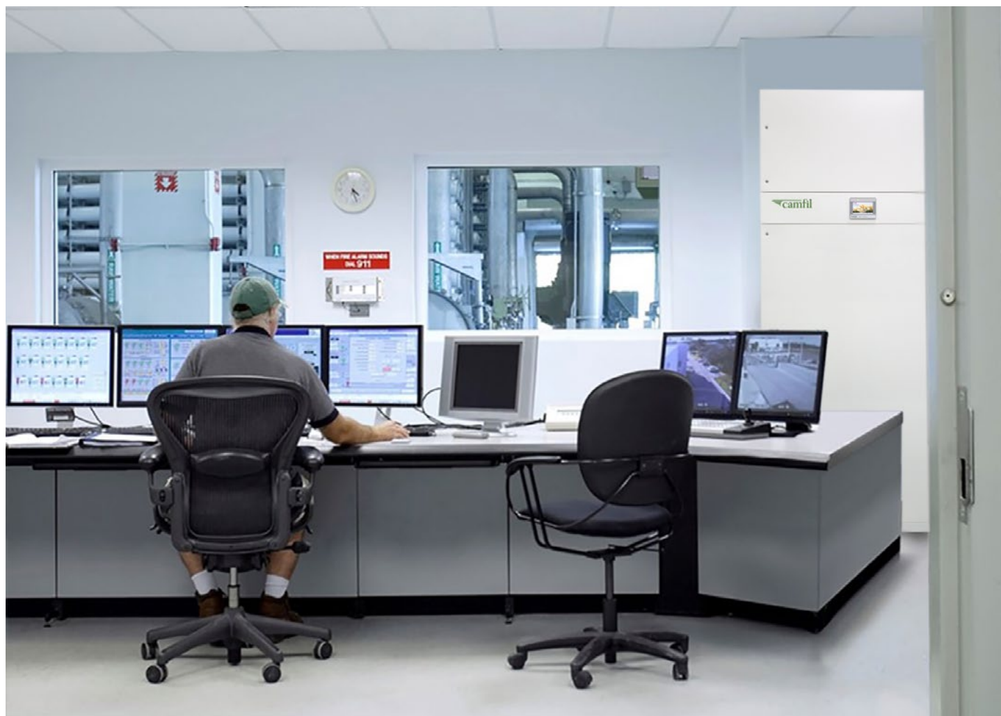
CC 1700 luftrensere i et kontrolrum
